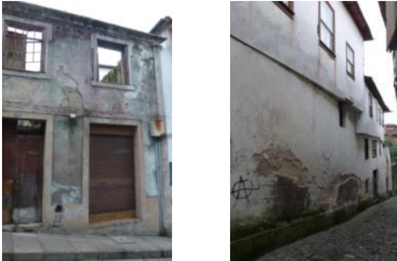
Fig. 11 - Imagens de degradação do património edificado
